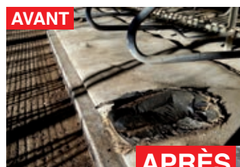
Matelas concurrent avant réparation
